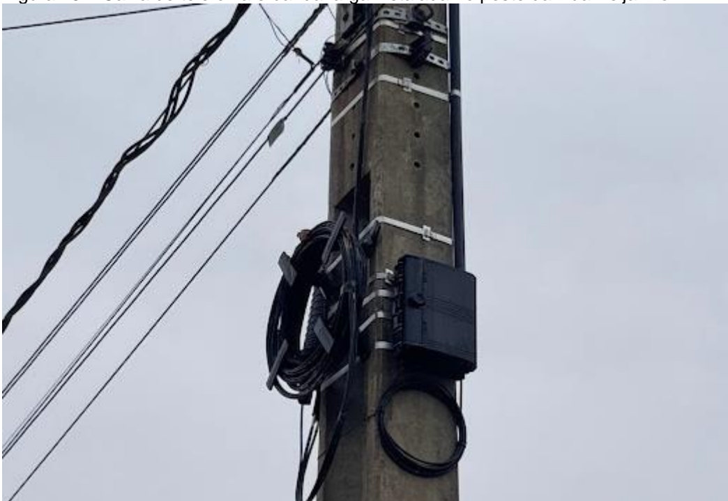
Figura 28 – Caixa de telefonia e banda larga instalada no poste da Rua Beija-Flor
