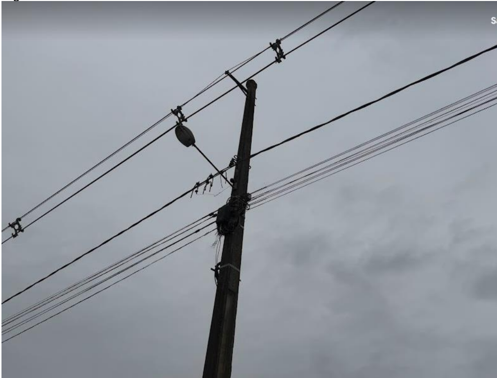
Figura 24 - Rede de alta e baixa tensão na Rua Maria de Oliveira Berti
