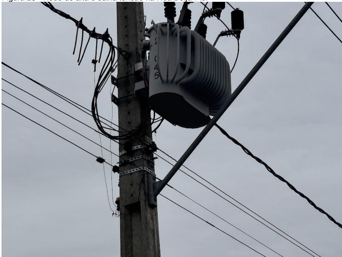
Figura 26 - Rede de alta e baixa tensão na Rua Beija-Flor
