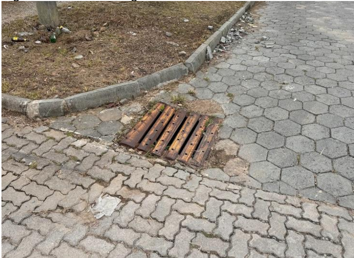
Figura 23 - Boca com gralha metálica na Rua Maria de Oliveira Berti
