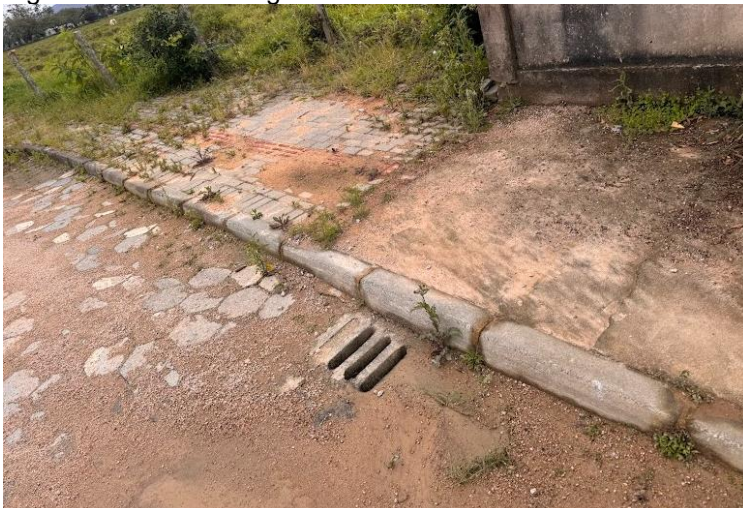
Figura 24 - Boca com gralha metálica na Rua Devanir Bonfim da Fonseca
